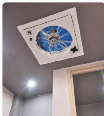
照明・換気扇
